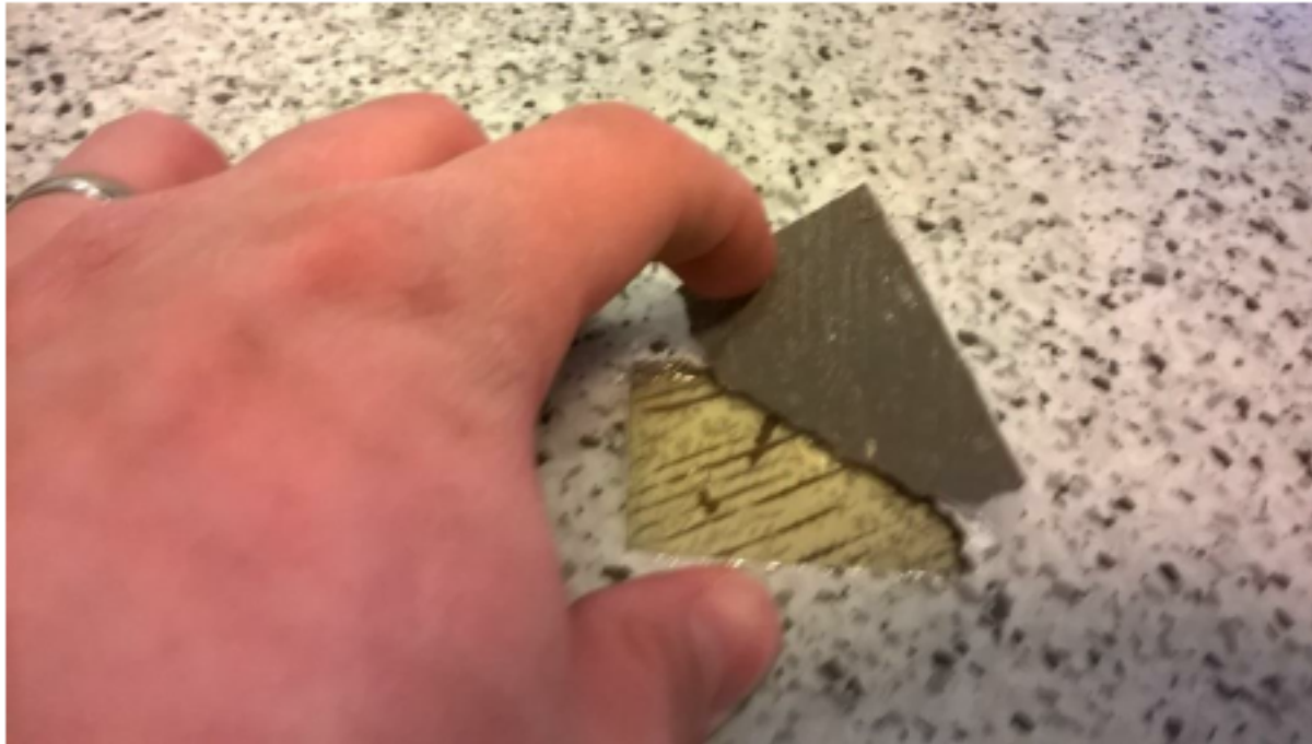
Kuva 2. Mattoliiman havaittava värinmuutos, voimakan 2-etyyli-1-heksanolin haju sekä vettä mattopinnoitteen alla päiväkeskuksen kerhotilassa.
